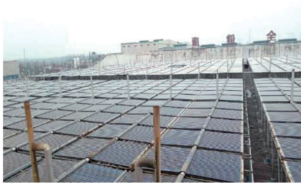
Solar Collectors 太陽能集熱設備
